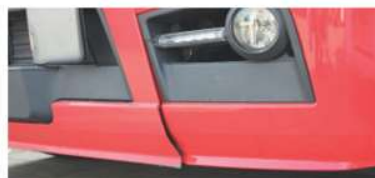
✗ Zderzak - znaczące uszkodzenia wykraczające poza normalne ślady zużycia • Duże otarcia, pęknięcia materiału lub połamany materiał
